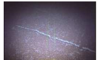
底版・損傷状況
