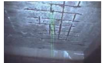
頂版・鉄筋露出
